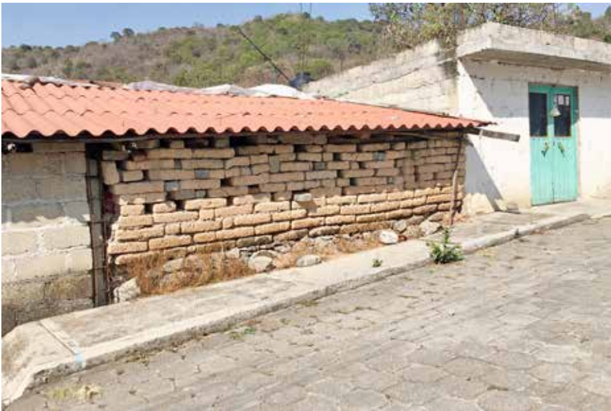
Imagen 25 Adobe viejo y mal puesto
