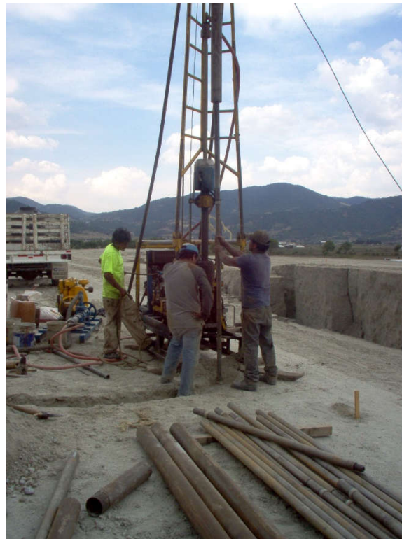
Figura 3 Falla por capacidad de carga (esfuerzo cortante) de un terraplén en Lerma en 2010.
