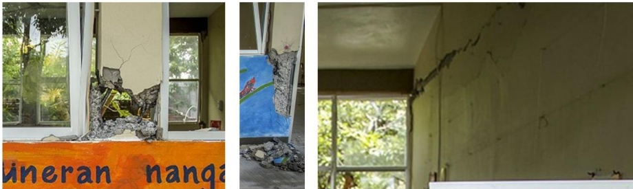
Figura 7 Daños observados en la escuela ubicada en Tetela del Volcán
