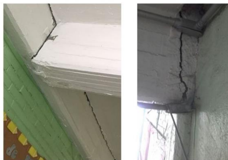
Figura 8 Daños observados en la escuela ubicada en Tehuacán
