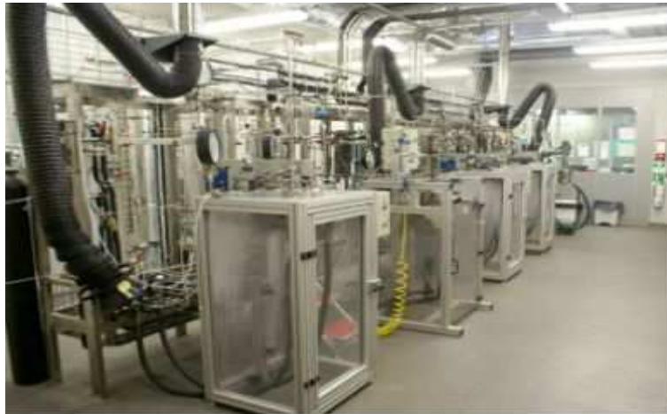
Figura 23. Instalaciones químicas con partes plásticas elaboradas con LDPE reciclado [37].
