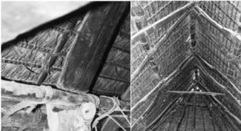
Figura 9. Detalle de amarre de horcones con la solera y las tijeras. Vista interior de la cubierta.
