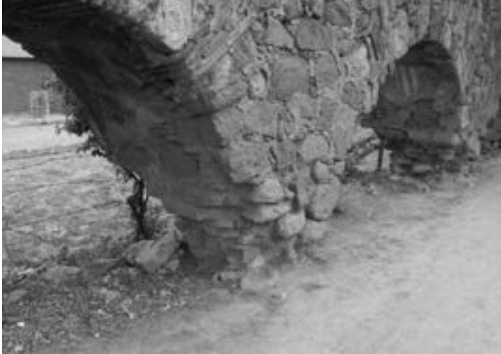
Figura 4. Pérdida de área resistente en la base de los arcos.
