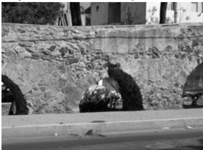
Figura 6. Falla de uno de los arcos por asentamientos.
