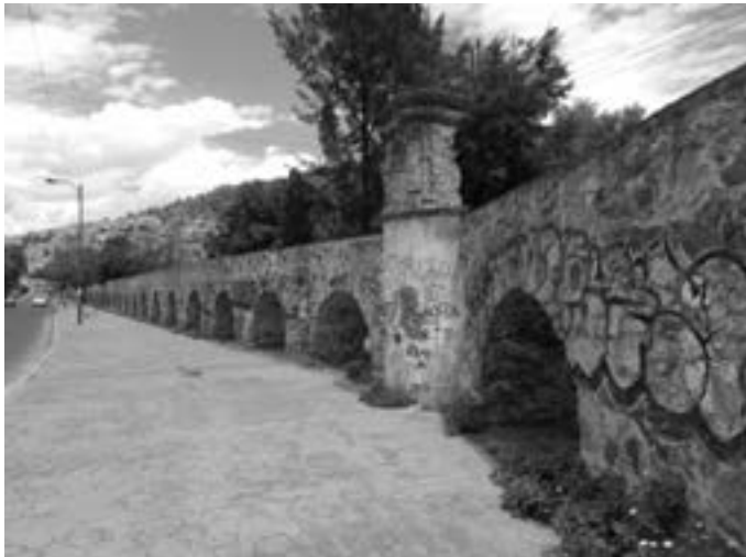
Figura 5. Se observa el descuido y el maltrato del acueducto.
