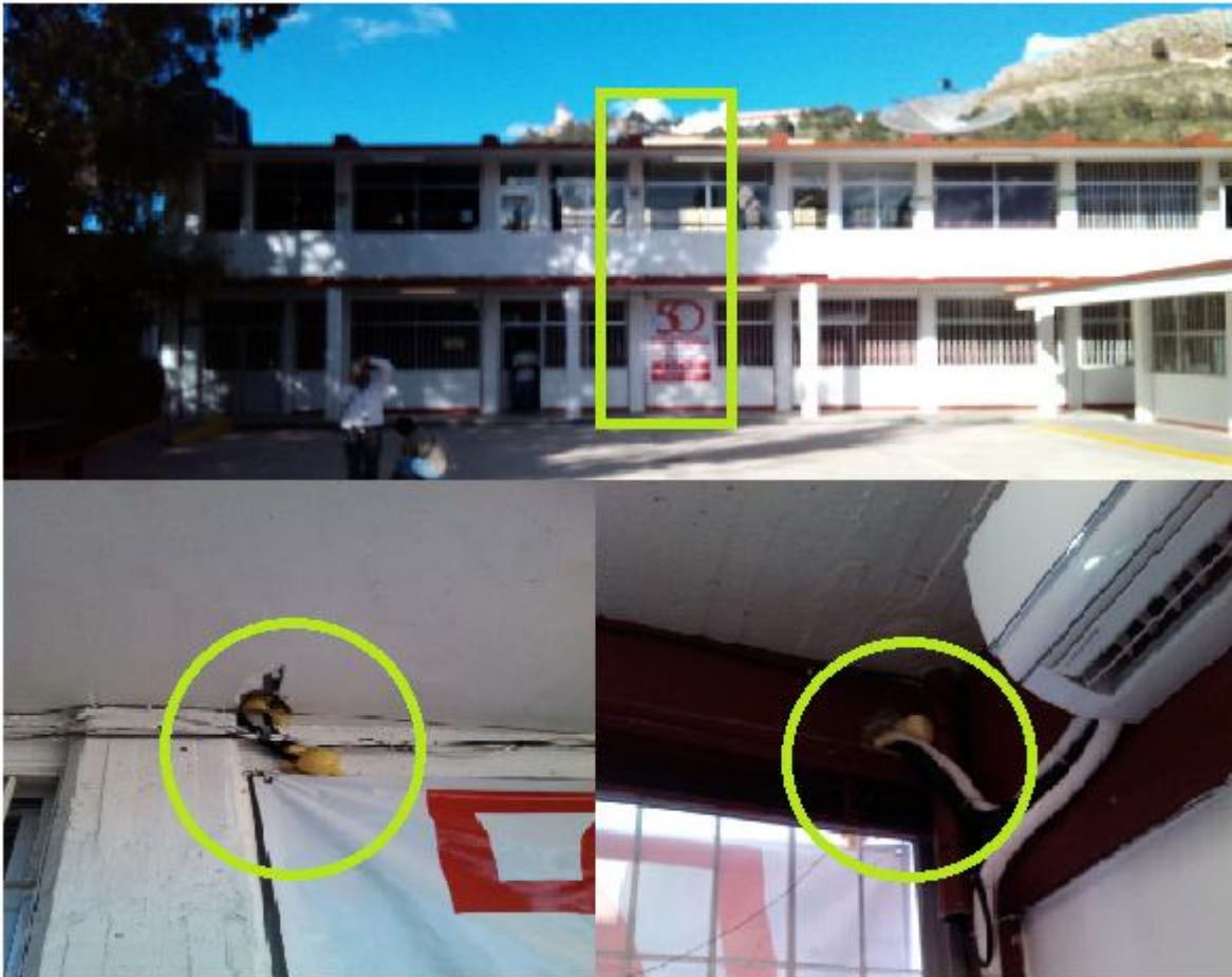
Figura 15. Paso de las instalaciones especiales por elementos estructurales, por remodelación
