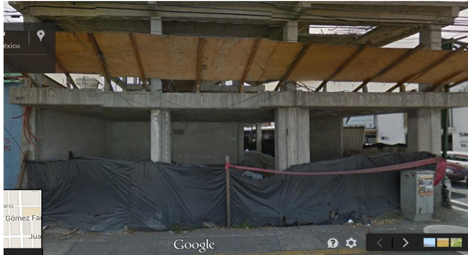
Figura 4. Muestra la adición como refuerzo de cuatro columnas una vez terminada la obra negra en el primer nivel ranurando el sistema de losa
