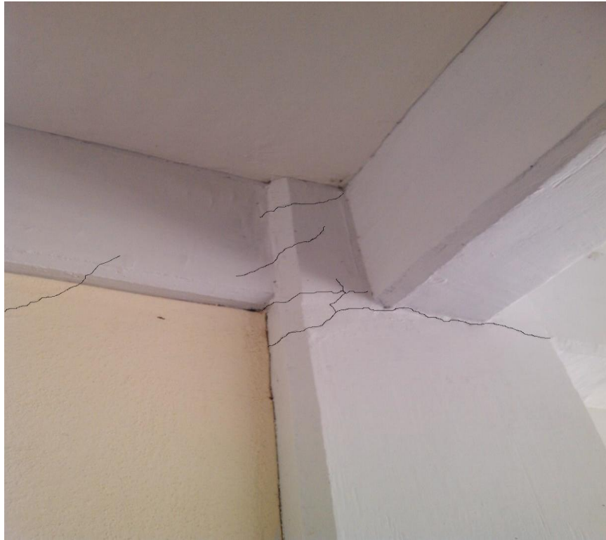
Figura 12. Grietas continuas de la planta baja hacia la azotea en la zona de las escaleras en una escuela de Aguascalientes
