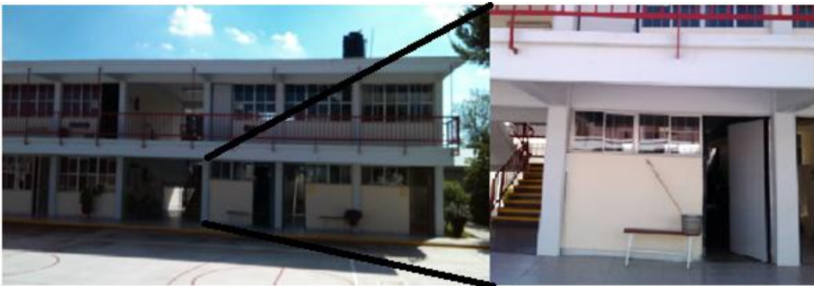
Figura 10. Deformaciones por asentamiento en una escuela de Aguascalientes
