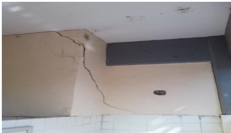
Figura 11. Grietas y asentamiento en la zona de baños en una escuela de Aguascalientes
