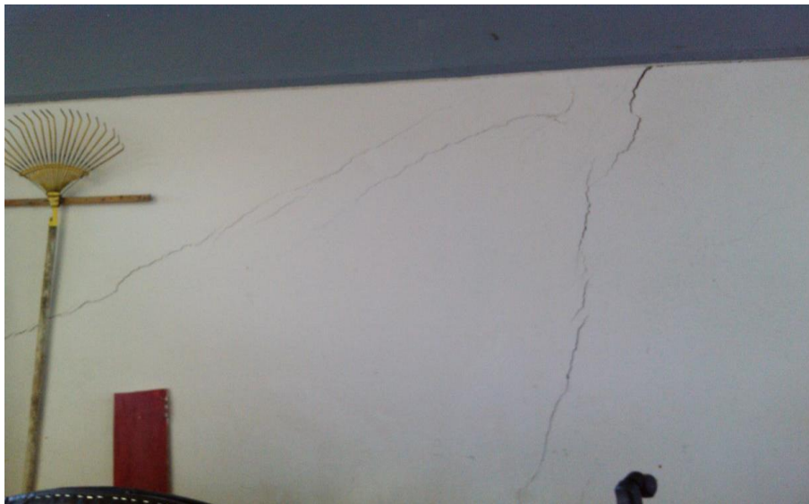
Figura 13. Grietas en la planta baja en la zona de almacén en una escuela de Aguascalientes
