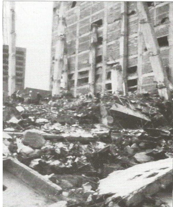
Figura 14. Falla de un edificio a base de losas planas por punzonamiento de losa.
