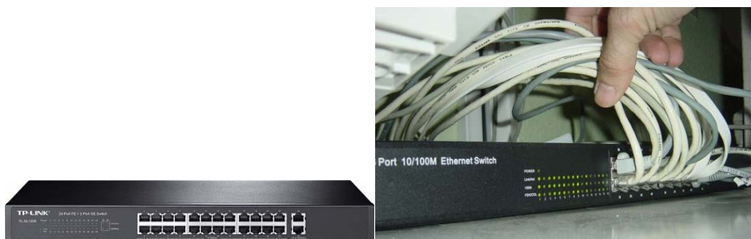
Ilustración 31: Conexión de equipos de cómputo al Switch. Marca Encoré, con 24 puertos de 10 a 100 M. ETHERNET Rack-Mount Switch Fuente: Creación propia.
