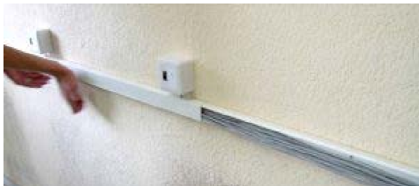
Ilustración 29: Instalación de cable Ethernet dentro de las canaletas. Fuente: Creación propia.
