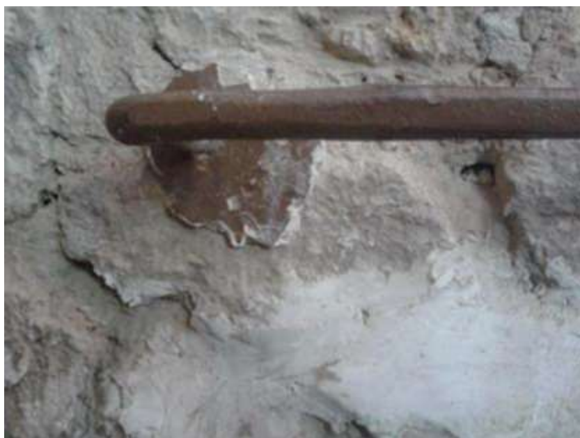
Figura 80. Detalle de capa de yeso y cal. Fotografía tomada por SCG el día 02/03/15.
