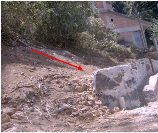
Figura 6 La pendiente del terreno favorece el desprendimiento de materiales.
