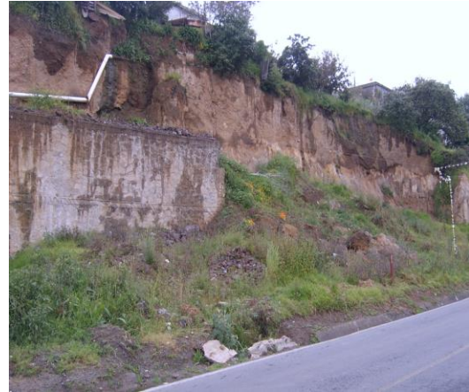
Figura 7 La pendiente del terreno y la presencia de agua acelera el desprendimiento de bloques.
