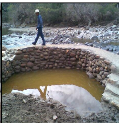
Fig. 13 Pozo salitroso sin mantenimiento, ensuciado y olvidado, inutilizado.
