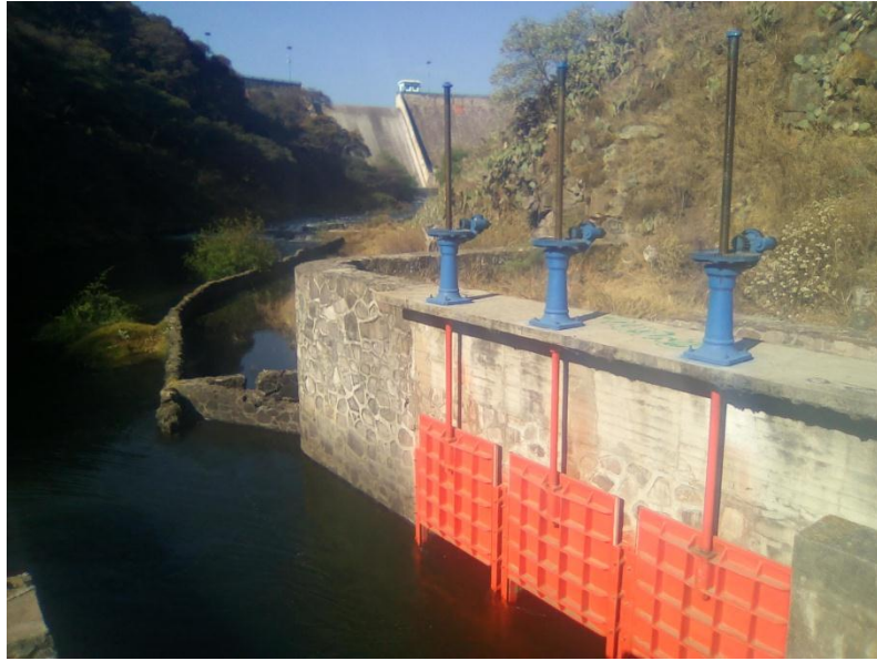
Foto 10: Compuertas principales hacia los canales Enyege y Tepetitlán.
