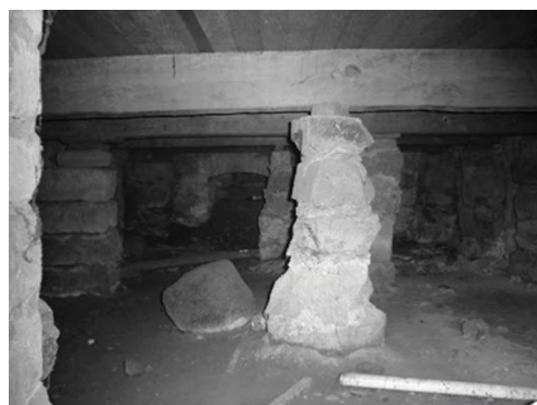
Semisótano. Vigería de encino. Nótese el soporte de mampostería y al fondo una cimentación perimetral arcada. Calle Plutarco González 107-Toluca.
