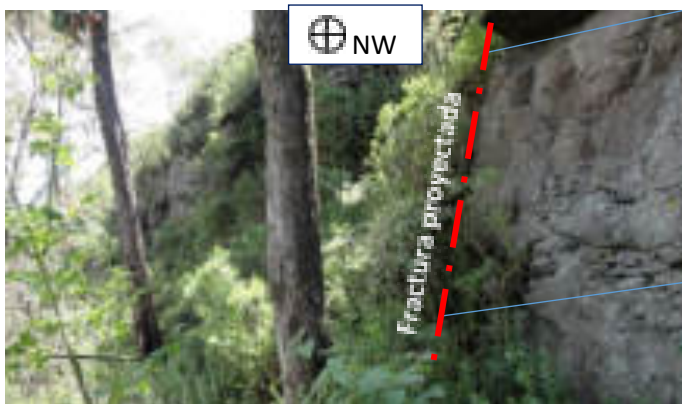
Figura 3.40 Sistemas de fracturas en escarpes de derrames lávicos, hacia sus partes bajas generan deslizamientos de tierra.
