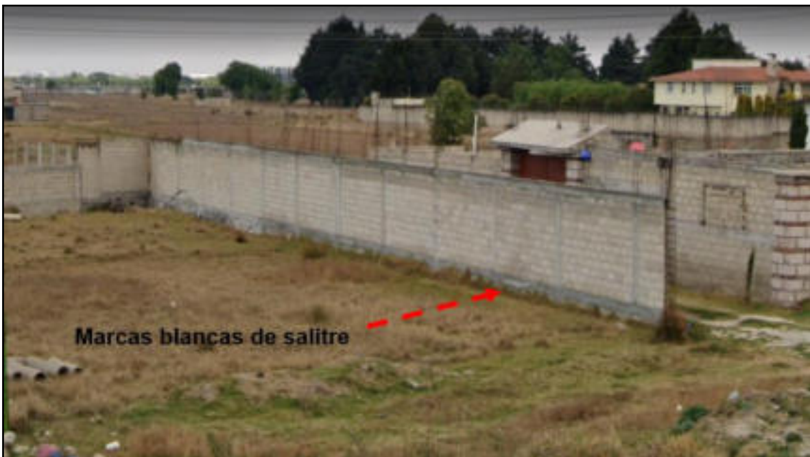
Figura 5.7 Marcas de salitre (rasgos de humedad constante) en la parte inferior de las construcciones.
