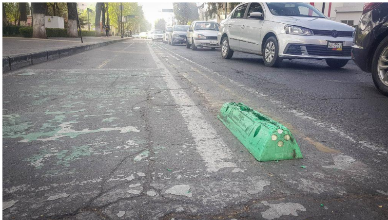
Imagen 14: Deterioro en la ciclovía
