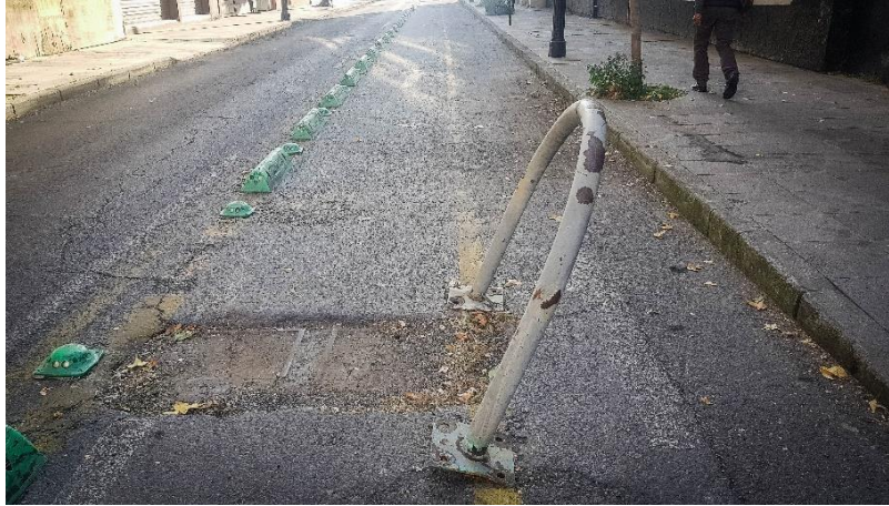
Imagen 41. Condiciones actuales de los elementos en la ciclovia.
