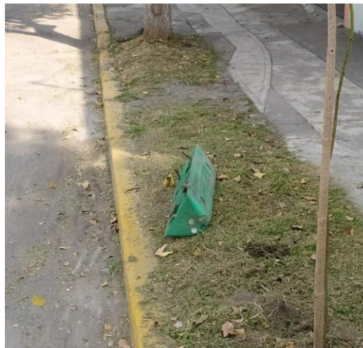
Imagen 42. Condiciones actuales de los elementos en la ciclovia.
