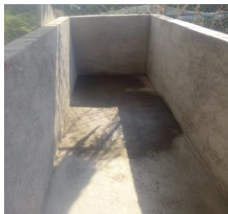
Figura 4. Lecho visto desde la parte interior
