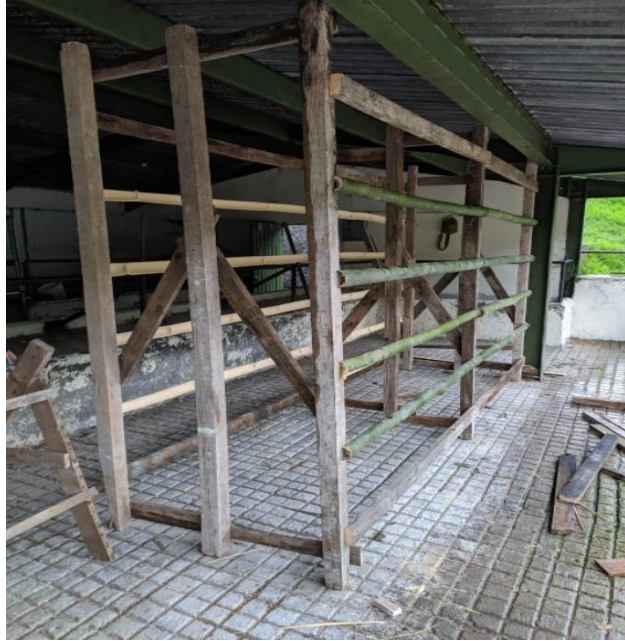
Ilustración 21: Elaboración del rack o anaquel para la producción de FVH (autor propio).
