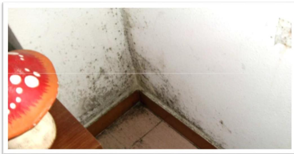
Imagen 12. Presencia de humedad de cimientos a muros. Elaboración propia
