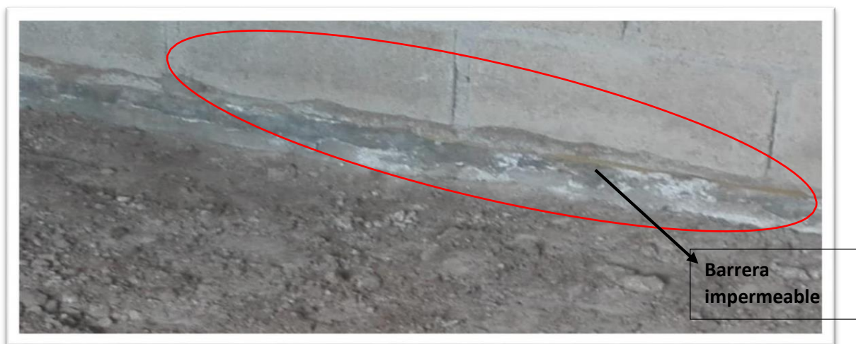
Imagen 40. Muros completos sin aplanado de la recamara principal.
