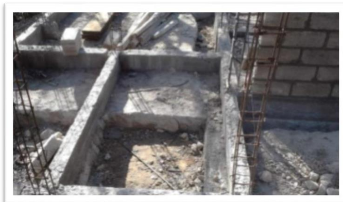
Imagen 15. Humedad de obra. Elaboración propia
