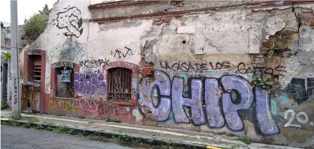
Imagen 5. Exterior de una propiedad abandonada y en deterioro
