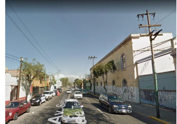
A I. 3. Fachadas en mal estado y vandalizada
