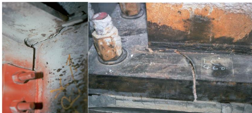
Figura 1-1. Modo de falla en conexión Pre-Northridge en soldadura y placa base (Crisafulli 2018)
