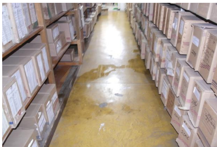
Ilustración 68: Pasillos del archivo mojados por las goteras
