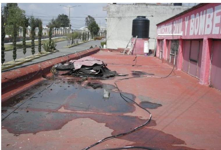
Ilustración 61: Condiciones del techo del archivo municipal Fuente: Elaboración propia
