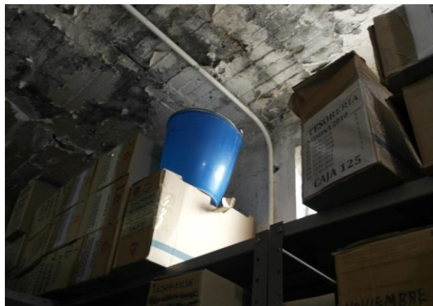
Ilustración 63: Problemas de goteras Fuente: Elaboración propia
