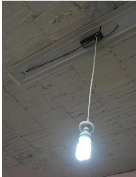
Ilustración 54: Cableado de luz expuesto
