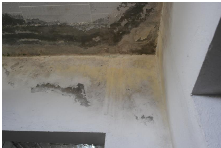
Ilustración 58: Humedad en techos y muros
