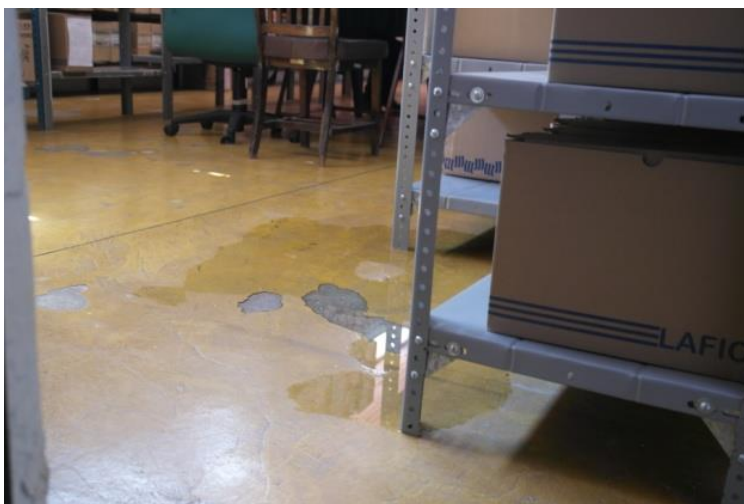
Ilustración 67: Pisos con presencia de agua por las goteras
