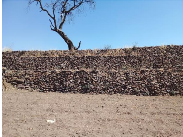
Figura 24. Muro frontal-superior de roca de la terraza no. 8 en la ladera sur.
