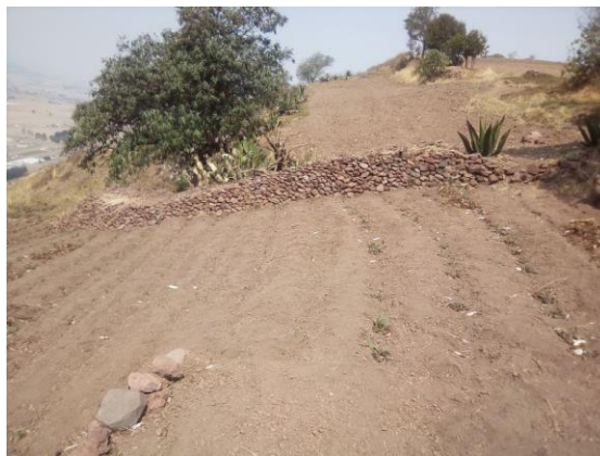
Figura 25. Muro izquierdo de roca de la terraza no.8 ubicada en la ladera sur.
