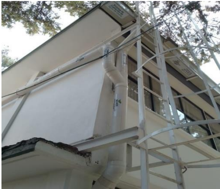
IMAGEN 4. Sistema de captación de aguas pluviales
