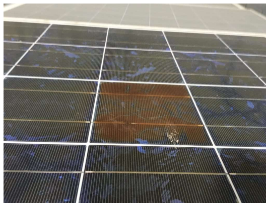
Figura 2.9: Daños en un panel solar provocados por un sobrecalentamiento [4].
