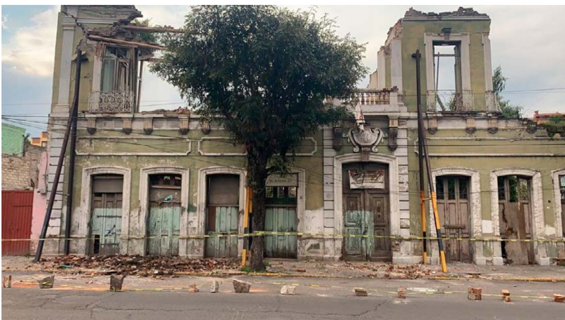
Fotografía 2. Fachada colapsada y apuntalada ubicada en la avenida Sebastián Lerdo de Tejada Fuente: La Jornada (2021).
