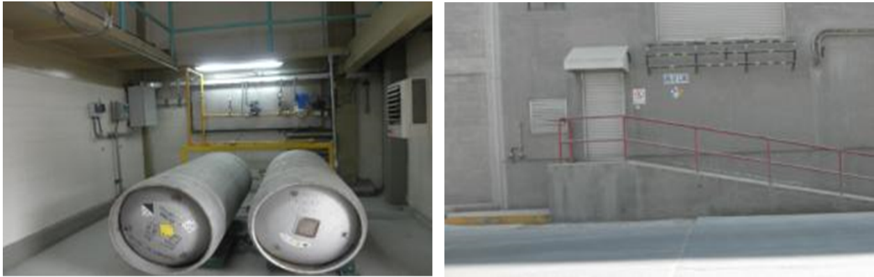
Figura 5. Almacén de gas cloro con los tanques (izq.) y vista externa del almacén (der.) Fuente: Elaboración propia. Fotografías tomadas por el sustentante.
