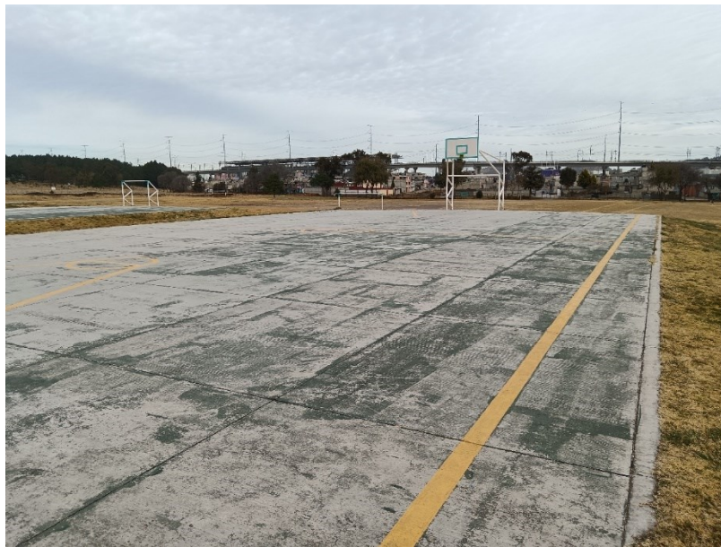
Imagen 30. Canchas multiuso deterioradas.
