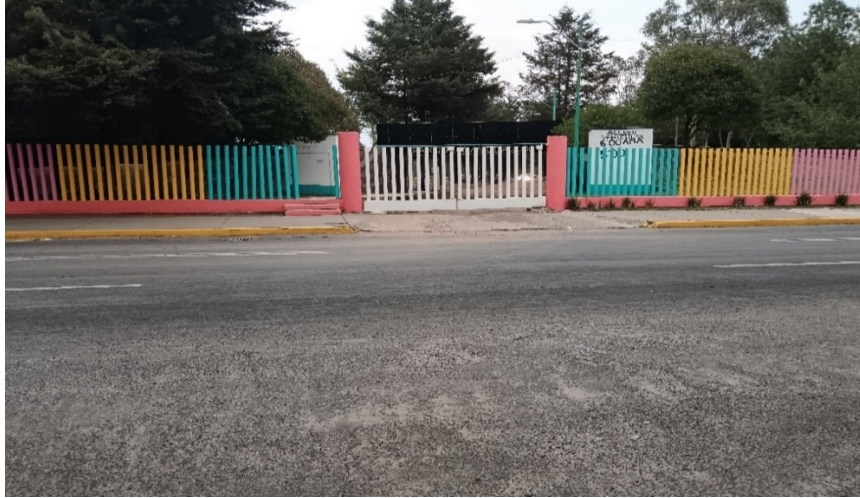
Imagen 20. Barda perimetral inconclusa.
