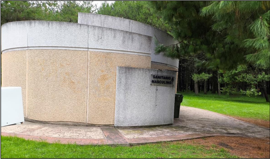
Figura 30. Módulo de sanitarios IV.
