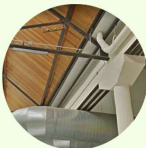
Fotografía 53 - Instalaciones visibles (Pluvial, Eléctrica y Ventilación) en Centro Tolzú - Jiménez / 2023 - Fuente: Elaboración Propia, 2023
