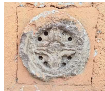
Fotografía 73 – Moldura en ventila en Fachada Histórica Norte del Inmueble "Mercado Bicentenario" – Jiménez / 2023 Fuente: Elaboración Propia, 2023
