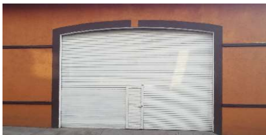
Fotografía 77 – Cortina metálica en Fachada Norte del Inmueble “Mercado Bicentenario” – Jiménez / 2023 Fuente: Elaboración Propia, 2023
