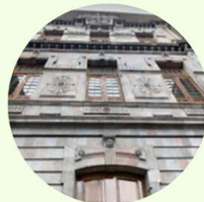
Fotografía 51 - Fachada Histórica en Centro Tolzú, Apreciación de revestimiento con cantera - Jiménez / 2023 Fuente: Elaboración Propia, 2023
