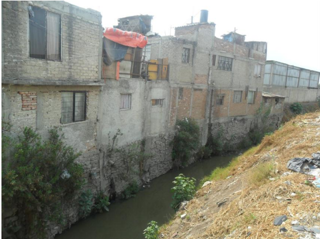
Foto no. 12 Casas violando el derecho de vía del río tomada desde otra.
