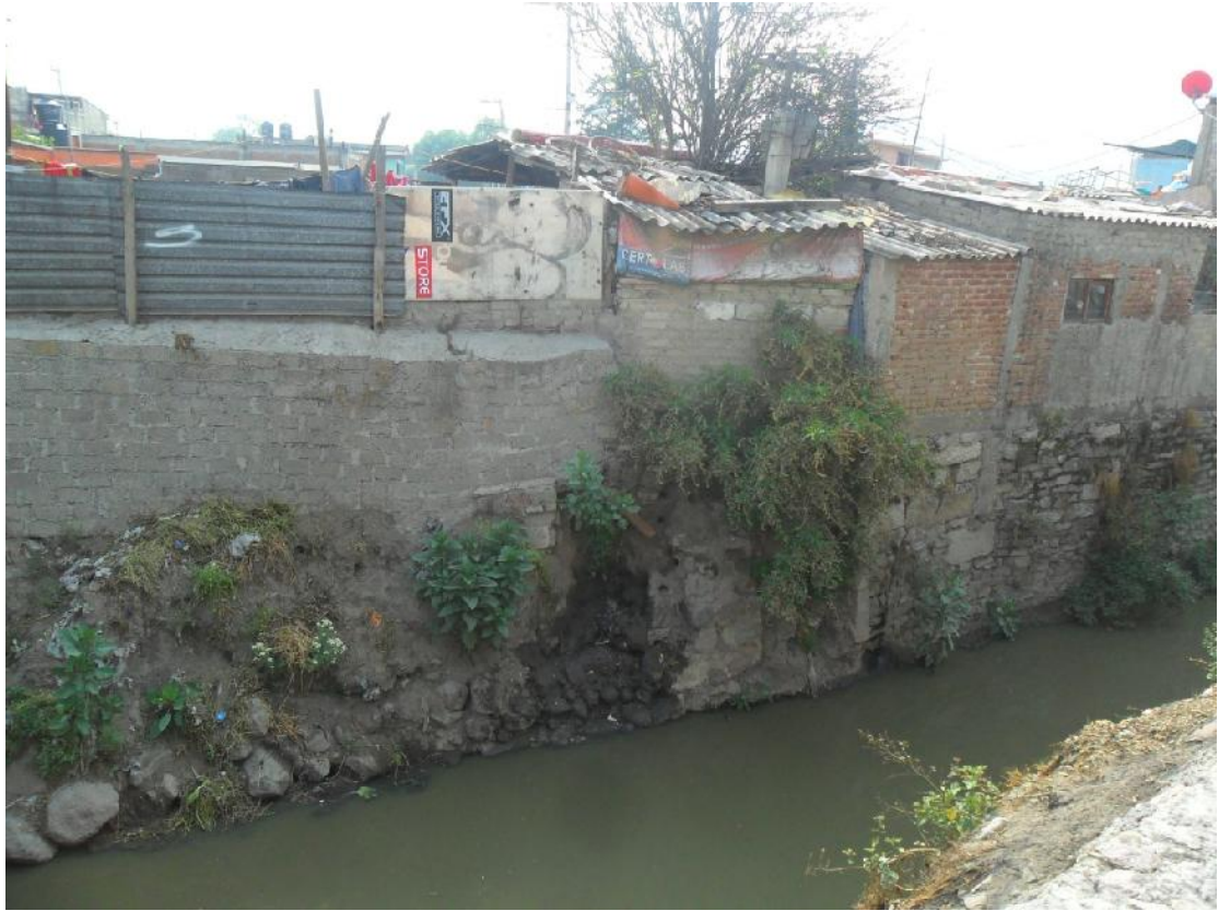
Foto no. 11 Casa a punto de Derrumbarse debido a la socavación que la corriente del canal de las cruces ocasiona en temporada de lluvias, dichas casa no respetan el derecho de vía, lo cual ocasiona un riesgo latente para la población en temporada de lluvias, con la cual no solo pueden perder su patrimonio y vida.
