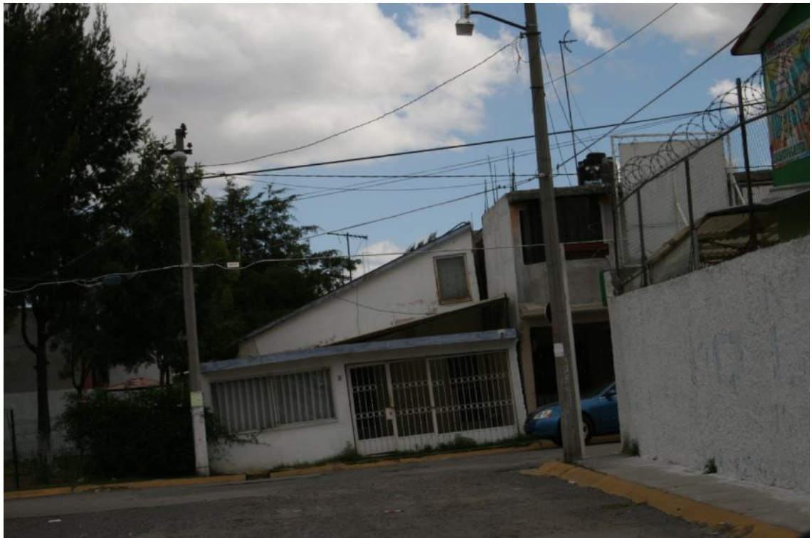
Foto no 8 Casa que presenta hundimientos, en la colonia San Pablo de las Salinas
