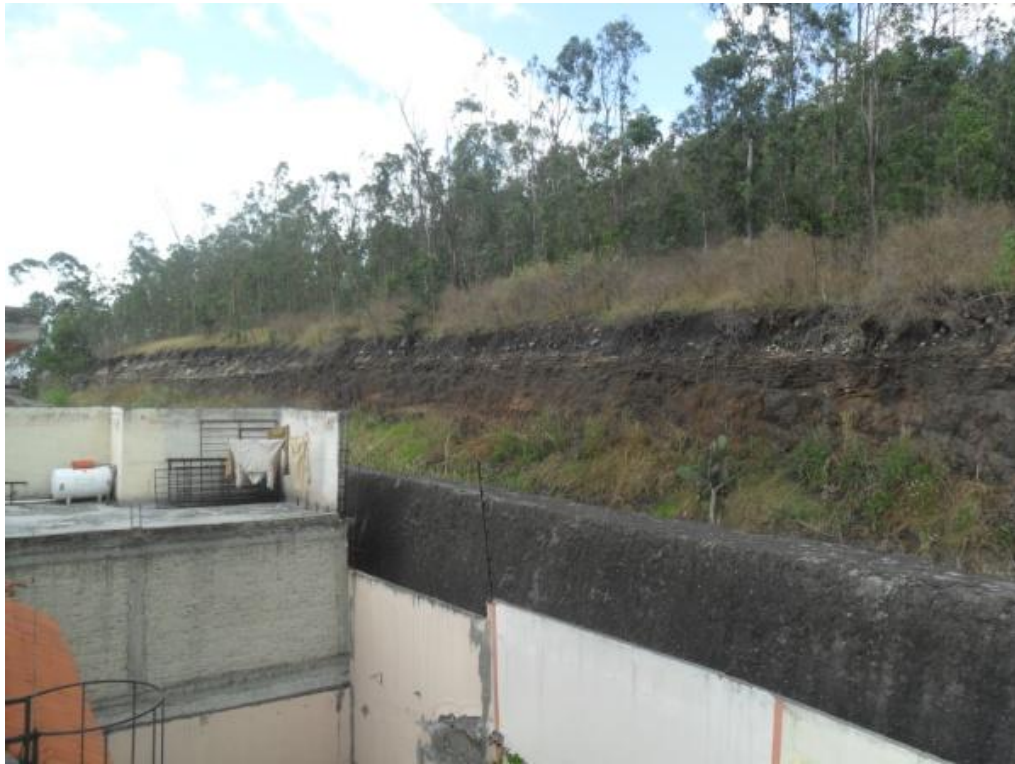
Foto no. 3 Laderas inestables adyacentes al Fraccionamiento Bosque de Tamarindos (Colonia Real del Bosque)
