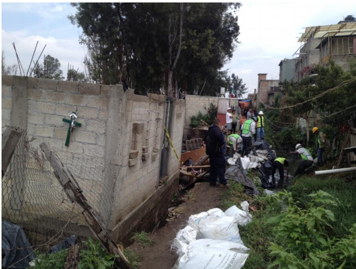
Foto no. 13 Asentamiento Irregular que Violaba el derecho de vía del canal, en la imagen se vislumbra a los elementos del Cuerpo de Bomberos realizan labores de ayuda y auxilio a la casa que fue derrumbada por la presión que el canal ejerció hacia los cimientos, Colonia el Pareja en la calle de Pirul s/n el día 11 de Septiembre del 2014.
