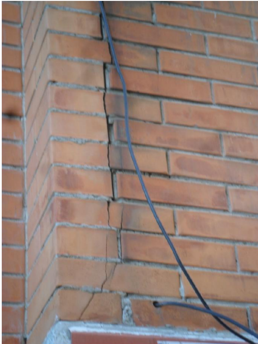
Foto no.2 Unidad habitacional que presenta hundimientos y grietas en su estructura en la colonia San Pablo de las salinas Fraccionamientos Granjas.
