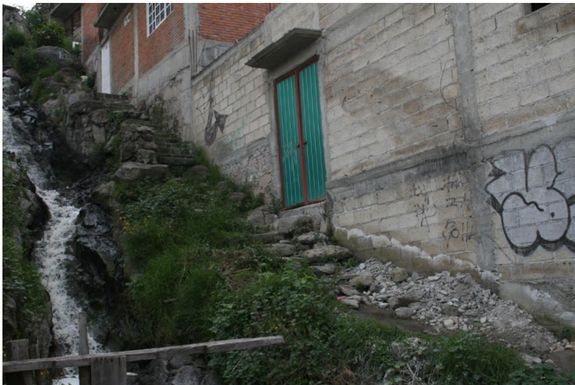
Foto no. 21. Ramal que pasa por casas de la Colonia el Paraje foto con zoom en la puerta de entrada principal a la casa en donde se observan las marca en la pared que alcanza el agua en temporada de lluvias.
