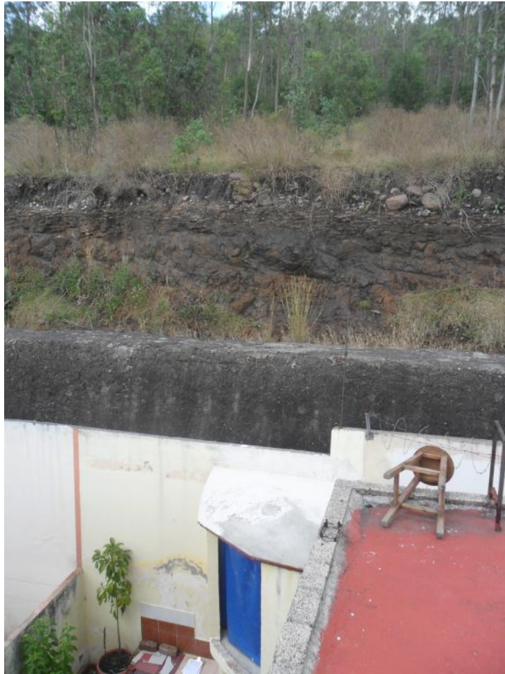
Foto no. 19 casa del Fraccionamiento Real del Bosque que presenta problemas de filtraciones de agua provenientes de la sierra de Guadalupe, en la imagen se aprecia cómo se corta el cerro y comienzan las casas, con un pequeño muro de contención que presenta problemas para conducción y desfogue de agua, ocasionando filtraciones de agua como se muestra en la imagen ocasionando arrastre de finos y problemas de hundimientos en las construcciones.
