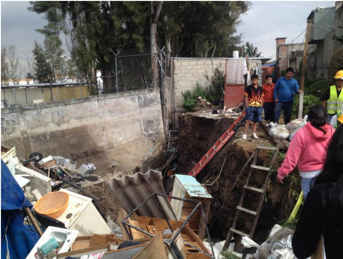
Foto no 14. Restos de la casa que colapso en la colonia el Paraje s/n el día 11 de Septiembre del 2014.
