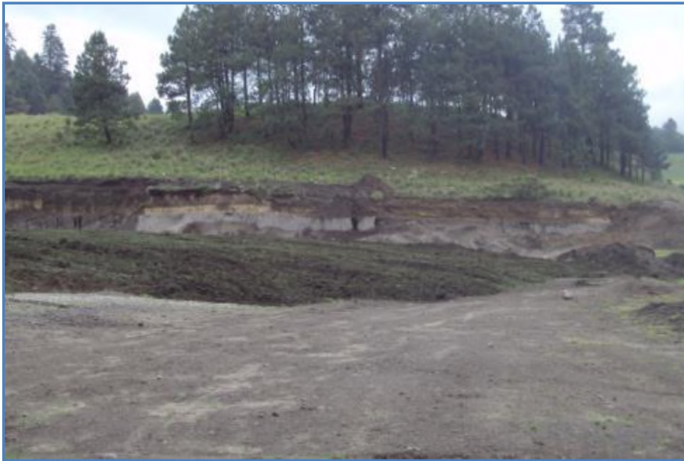
Figura 23. Ejemplo de un socavón a las orillas de Buenavista
