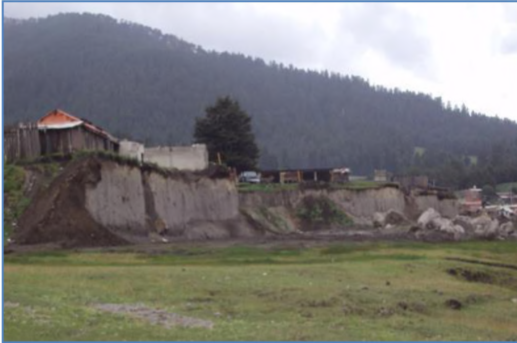
Figura 20. Paredes con incidencia de extracción
