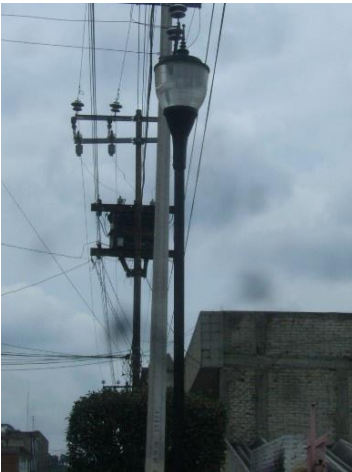
Foto 24. Transformador y poste
