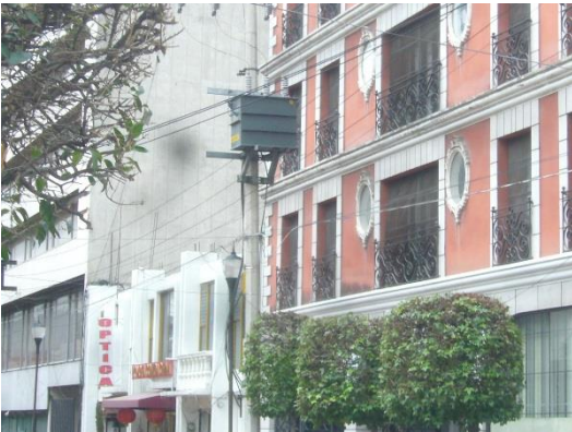
Foto 18. Transformador y alumbrado público
