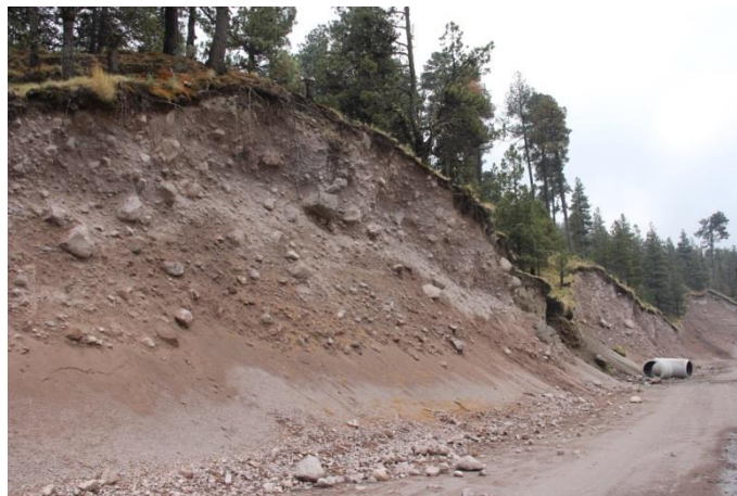
Fotografía 10: Inestabilidad de laderas por construcción de carreteras
