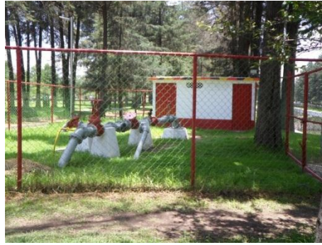
Figura 47. Bomba de agua. Localizada a un costado del lago. (Elaboración propia).
