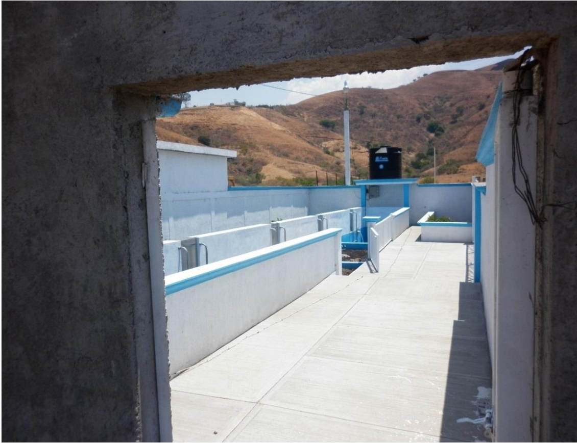
Figura 5. Área de tratamiento de aguas residuales. Rastro TIF, Lodo Prieto, Estado de México.
