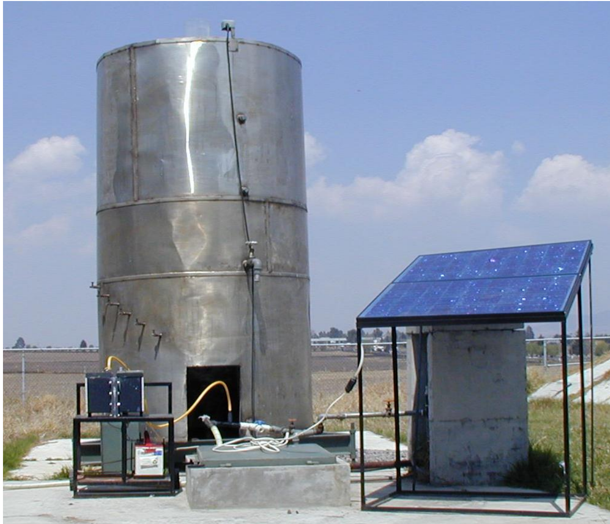
Figura 1.8. Fotografía de la planta potabilizadora piloto
