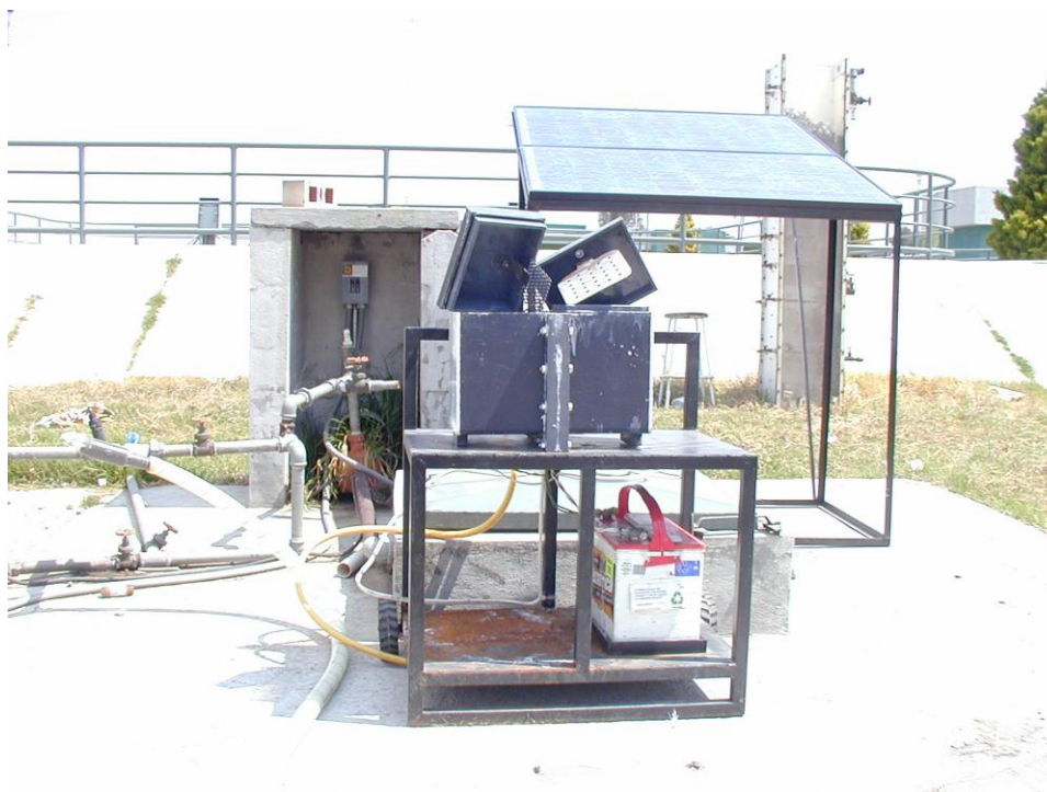
Figura M-4 Unidad de desinfección.
