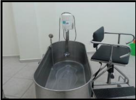
Figura 23. Hidroterapia. Tina con regulador y medidor de temperatura.
