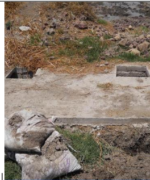
6. Muestra el colector que dirige las aguas de las localidades a la Laguna de Oxidación.
