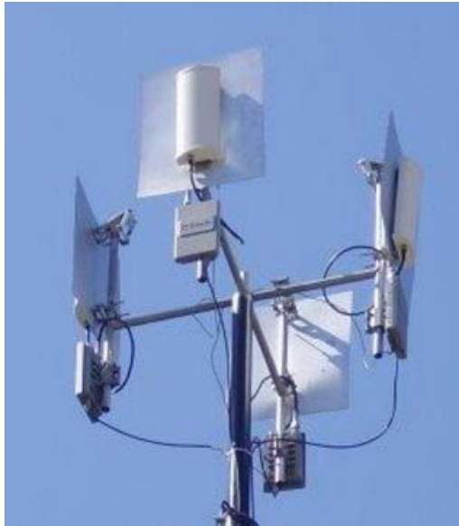
Figura 21. Colocación de varias antenas de alto poder, ( http://web.frm.utn.edu.ar/comunicaciones/antenas.html ).
