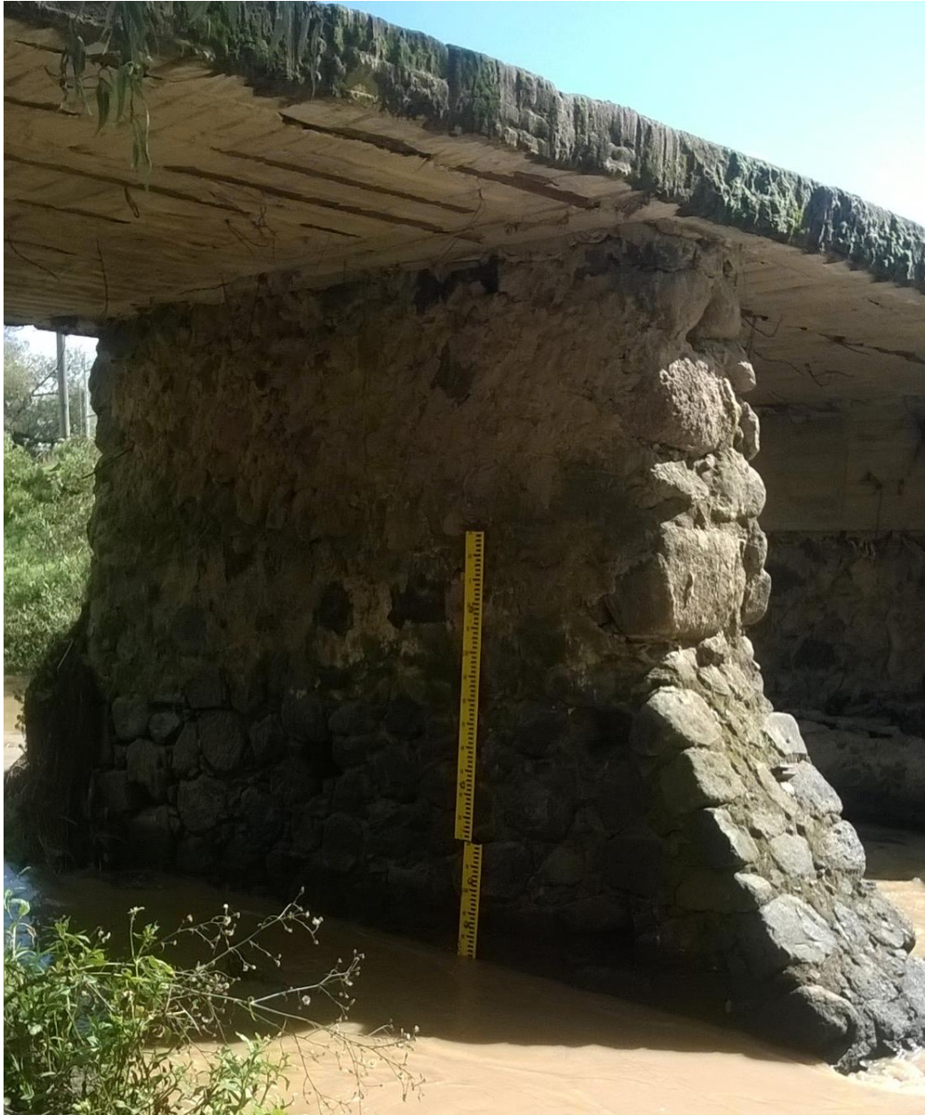
Figura 7.2. Escala limnimétrica instalada de 0 a 2.50 metros.
