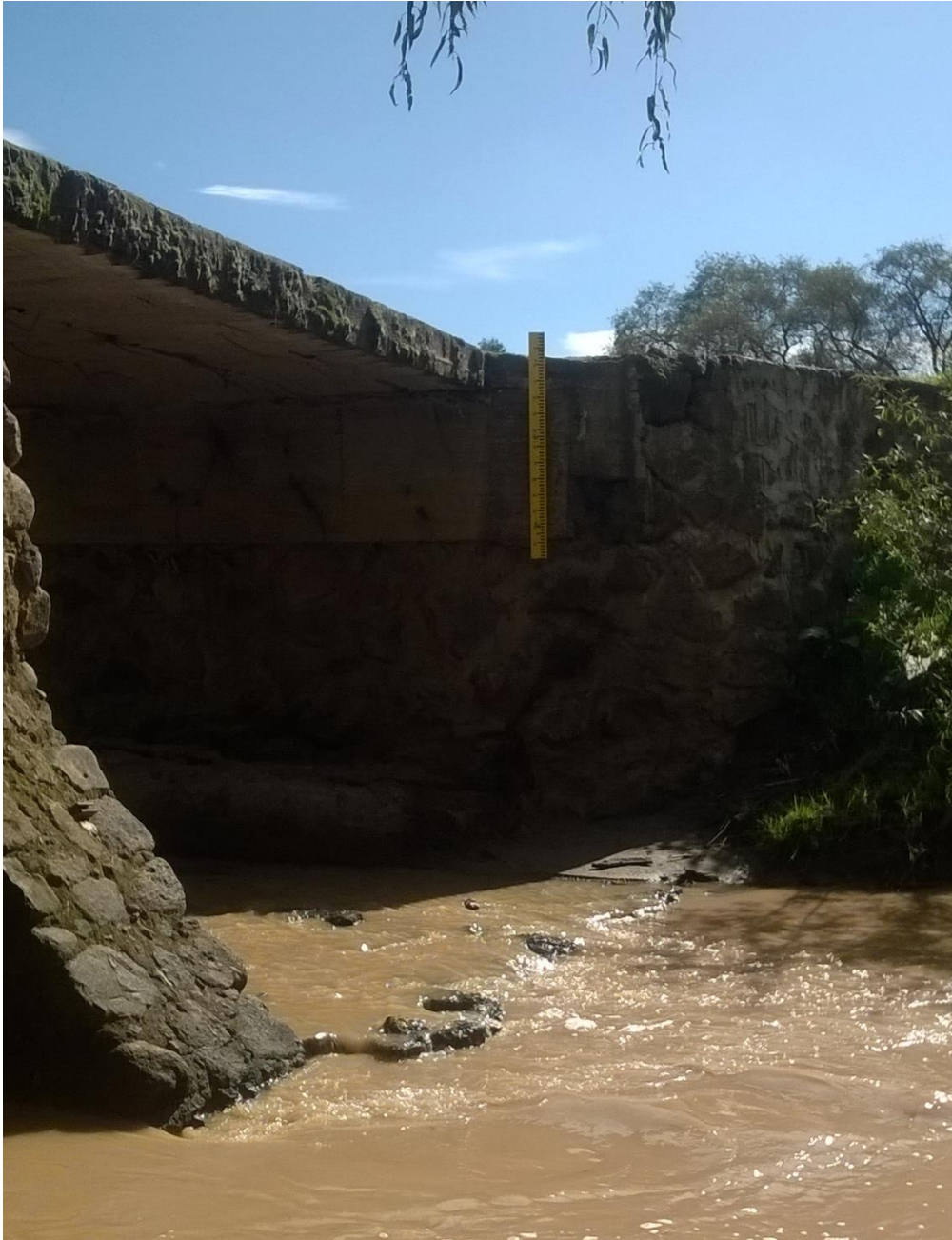
Figura 7.3. Escala limnimétrica instalada de 2.50 a 3.90 metros.
