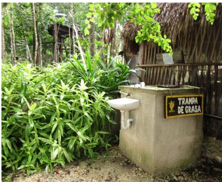
Fotografía 6. Trampa de grasa
