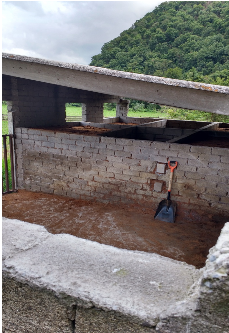
Figura 2. Piletas de cemento para depósito de residuos orgánicos, Granja Las Pulgas.
