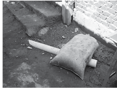
Figura 9. Tubo de PVC con salida a una zanja.
