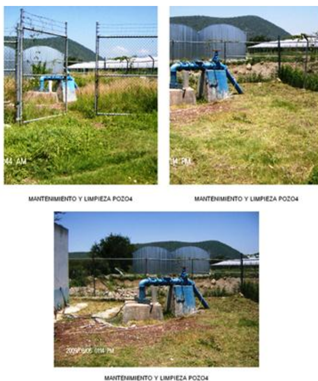
FIGURA No. 32, 33 y 34 Pozos de extracción de agua Potable.
