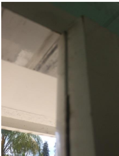
42._ Obstrucción de puerta
