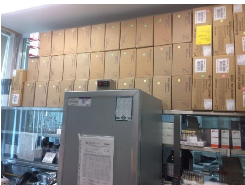
44._ Colocación de materiales sobre mobiliario que no está diseñado para soportar cargas a falta de espacio.
