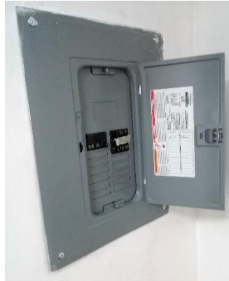
Figura 61. Centro de carga eléctrica.
