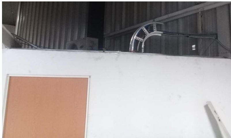
Figura 71. Entrada y salida de cableado estructurado al SITE BUFFER .
