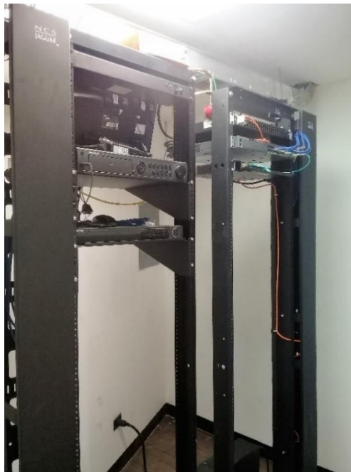
Figura 80. Equipos y dispositivos de red, imagen tomada desde dentro del sitio.
