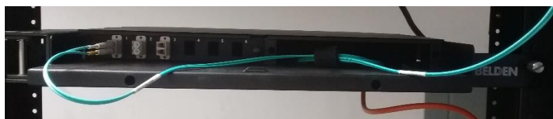
Figura 78. Instalación del DFO dirigido a IDF 2 .
