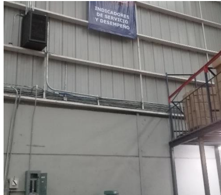
Figura 83. IDF 2 , ubicado en equipo especial.
