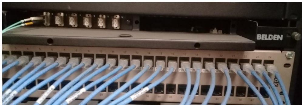
Figura 86. Fibra óptica y panel de conexión.
