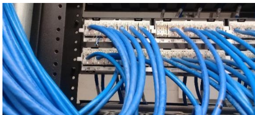
Figura 94. Panel de conexión del MDF SITE .
