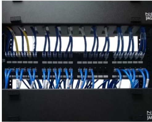
Figura 95. Conexión del panel de conexión al switch de VLAN 13.
