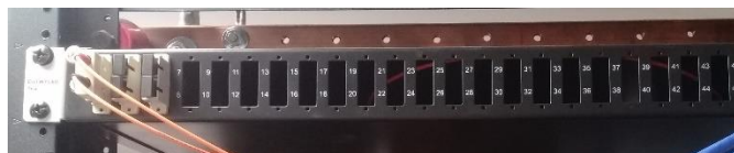
Figura 76. DFO , receptora de fibra óptica del MDF SITE .
