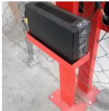
Figura 92. Contactos de corrientes y no break.
