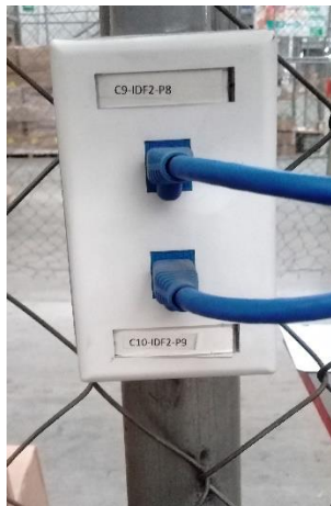
Figura 101. Ejemplo de una caja de nodo instalado.
