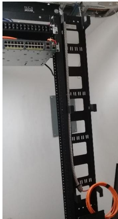
Figura 73. Trayectoria de fibra óptica en organizador vertical del rack.
