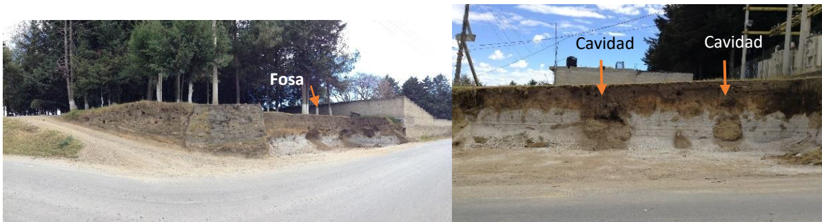
IMAGEN 44. CAJONES DE ESTACIONAMIENTO DONDE SE OBSERVAN LA EXPOSICIÓN DE LAS FOSAS IZQ E. SUR Y DER. E. NORTE. FOTOGRAFÍA POR ANA LAURA NAVARRO MARTÍNEZ
