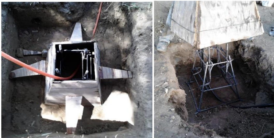
IMAGEN 38. ESTRUCTURA DE “DADO” QUE SOSTIENE LAS LUMINARIAS. FOTOGRAFÍA POR DANIEL GUEVARA ACOSTA
