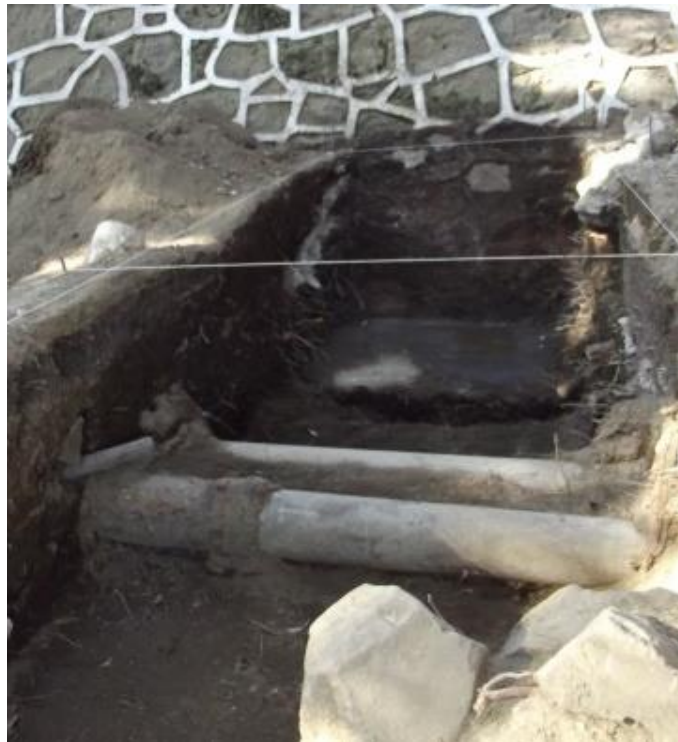
IMAGEN 39, CALA DE APROXIMACIÓN DONDE SE EVIDENCIA LA AFECTACIÓN DEL SITIO CAUSADA POR LA CONSTRUCCIÓN DEL DEPÓSITO DE AGUA. FOTOGRAFÍA POR ANA LAURA NAVARRO MARTÍNEZ
