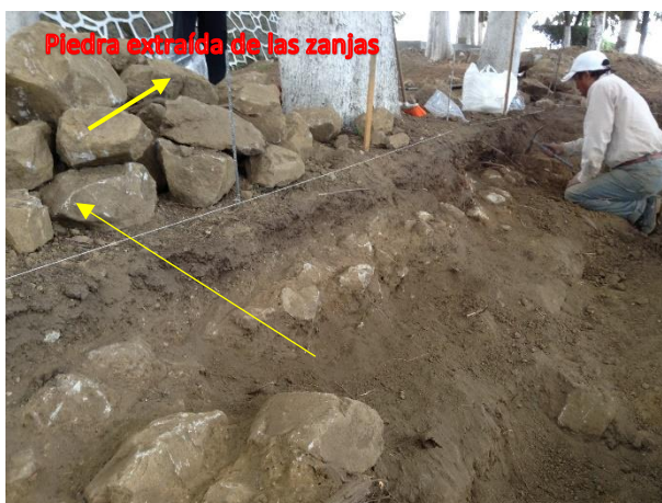
IMAGEN 41 PROCESO DE EXCAVACIÓN, EN DONDE SE OBSERVA LA PIEDRA EXTRAÍDA DE LAS ZANJAS TRAZADAS POR LA OBRA. FOTOGRAFÍA POR ANA LAURA NAVARRO MARTÍNEZ
